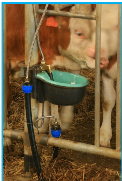
Ältere Kälber lassen sich gut mit leichtgängigen Selbsttränken mit Wasser versorgen. Gut ist der Anschluss an eine Zirkulationsheizung. Schlecht gelöst sind jedoch die freiliegenden Leitungen.
